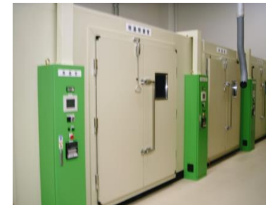
耐候性試験室 (高温・低温・恒温・降雨)
